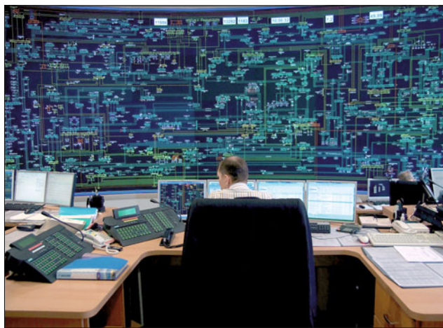
Современный диспетчерский щит филиала ОАО “Системный оператор Единой Энергетической системы” “Региональное диспетчерское управление энергосистемы Москвы и Московской области”
