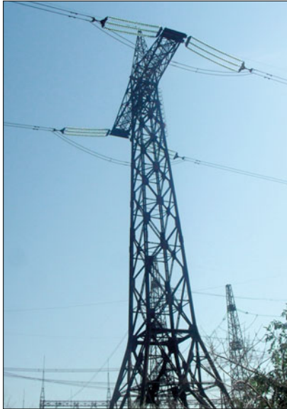
Опора ЛЭП Волгоград – Донбасс
