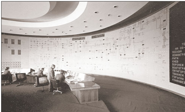
Диспетчерский щит ЦДУ ЭЭС СССР в новом здании на Китайском (сейчас – Китайгородском) проезде, 1976 г.
