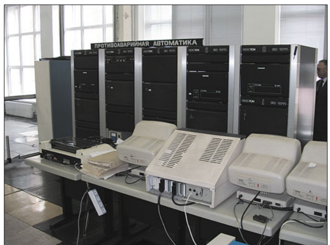
ЭВМ “Видеотон” ЕС-2011, на базе которых в 1990-е работали централизованные системы противоаварийной автоматики объединённых энергосистем
