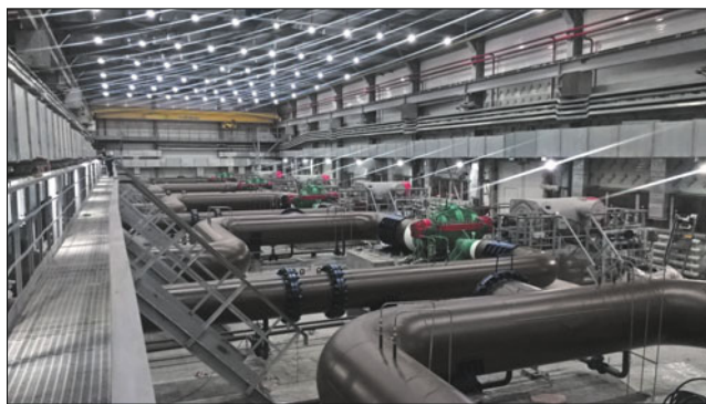
Насосная станция с двигателями производства НПО “ЭЛСИБ”
