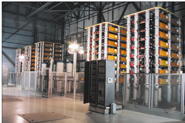
Вентильный зал комплектного преобразовательного устройства ПС Выборгская
